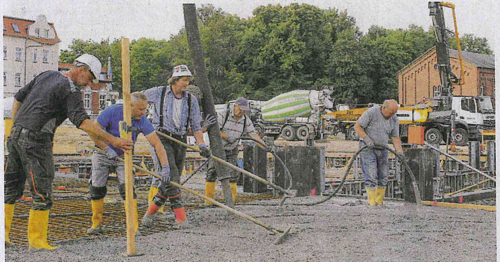
Mitarbeiter des Brüssower Bauhofes Eich haben am Freitag die 300 Kubikmeter Betonbewehrung für das DRK-Wohn- und Betreuungszentrum „Alte Poliklinik“ in Pasewalk gegossen.
