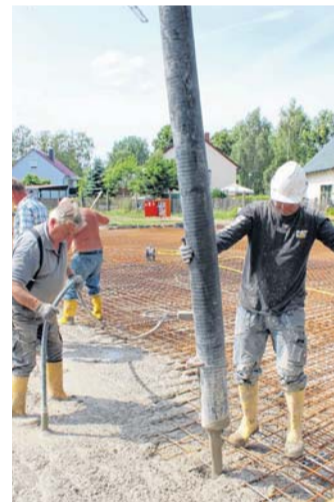
Eine schweißtreibende Arbeit: Innerhalb von 12 Stunden haben die vier Bauleute vom Bauhof Brüssow, um Polier André Stüpke (rechts), die 400 Kubikmeter Beton für die Grundplatte verarbeitet.
